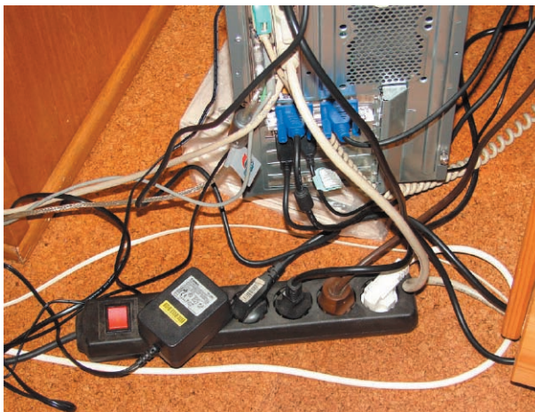
Schaltbare Steckerleiste mit angeschlossenen Geräten
