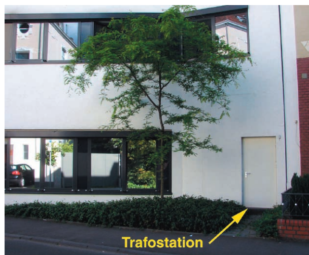
Trafostation hinter neutraler Stahltür
