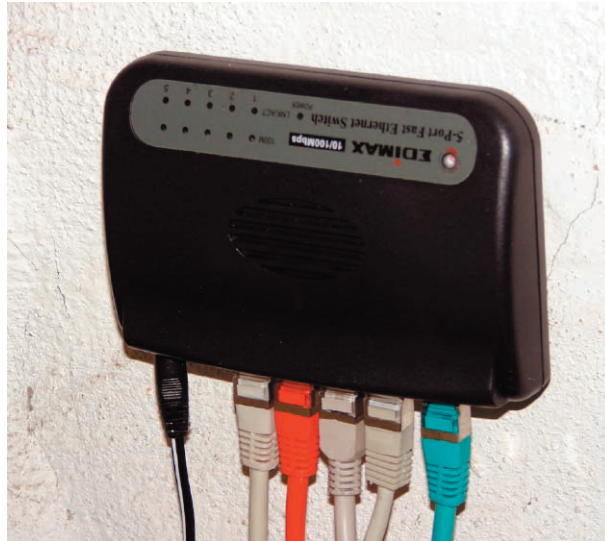
Switch eines Kabelnetzes
